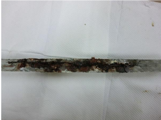
写真 15 : No.5 の腐食ひび割れの様子
