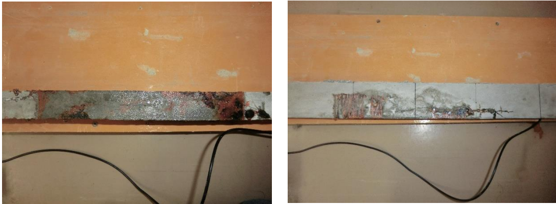
写真 11 : No.1 の腐食ひび割れの様子
