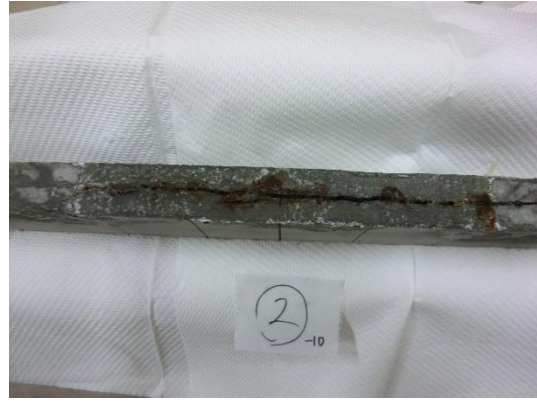
写真 14 : No.4 の腐食ひび割れの様子
