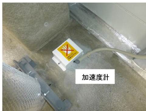
(2) 床面設置の加速度計(カバー付)
