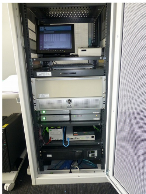
(4) ラック収納した観測装置
